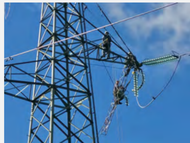
Sanacija posledic vandalizma
