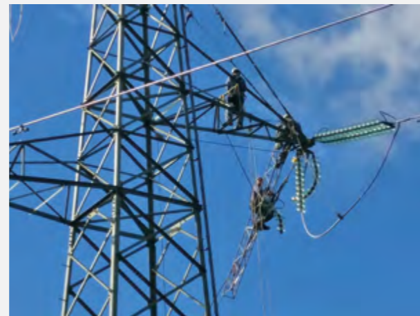
Sanacija posledic vandalizma
